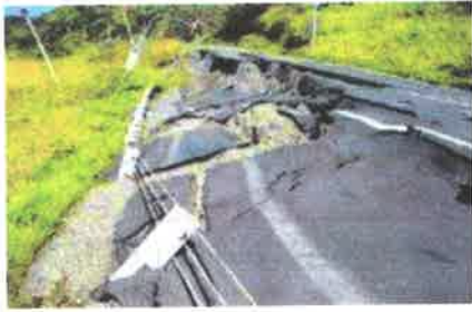
平成 15 年十勝沖地震（豊頃町）
