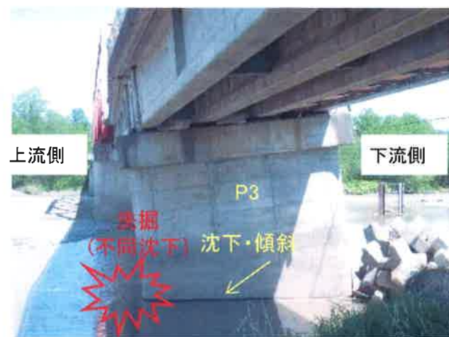
写②.P3橋脚の沈下・傾斜
