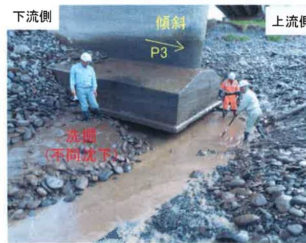
写③.P3橋脚の洗掘状況
