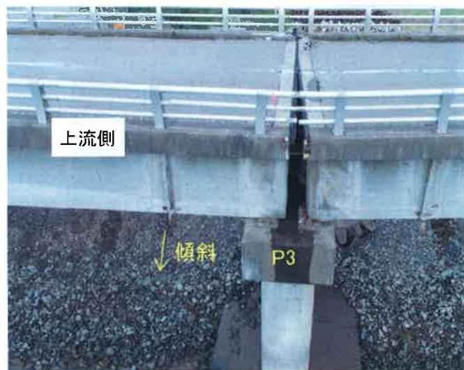
写④.上部工上流側の変状
