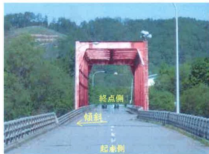
写①.上部工の変状
