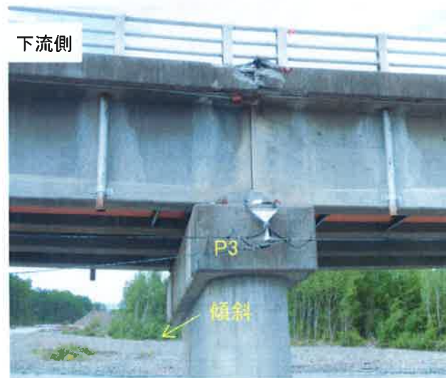
写⑤.上部工下流側の変状
