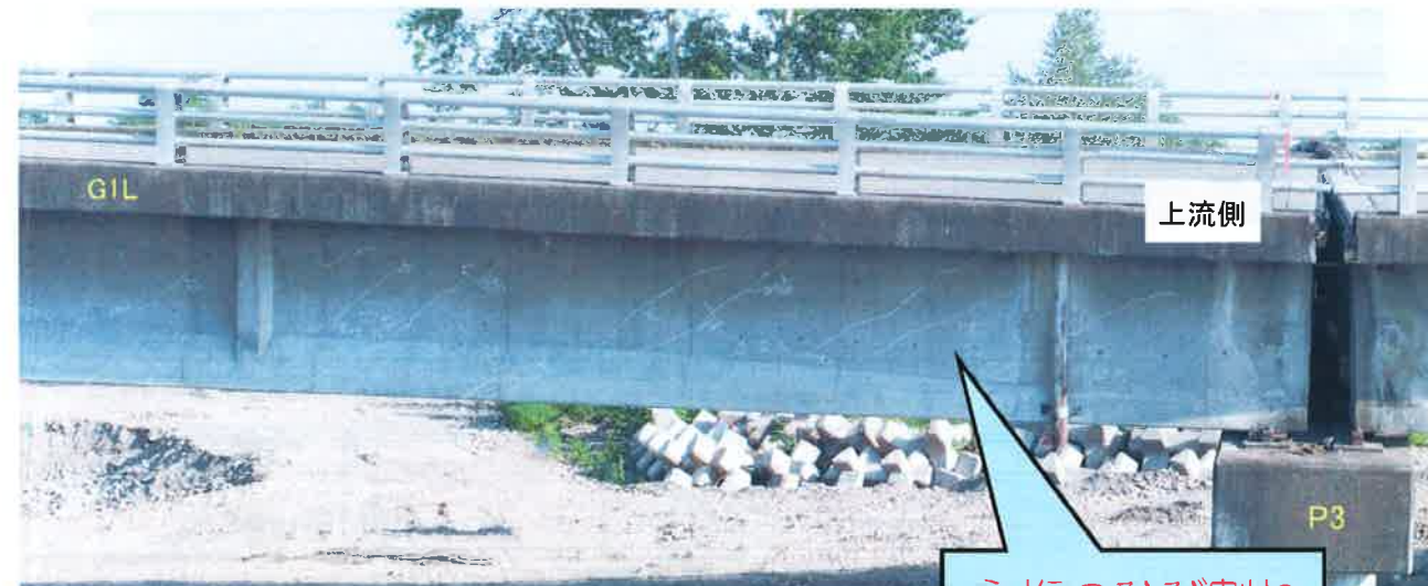
写⑥.主桁のねじれによるひび割れ
