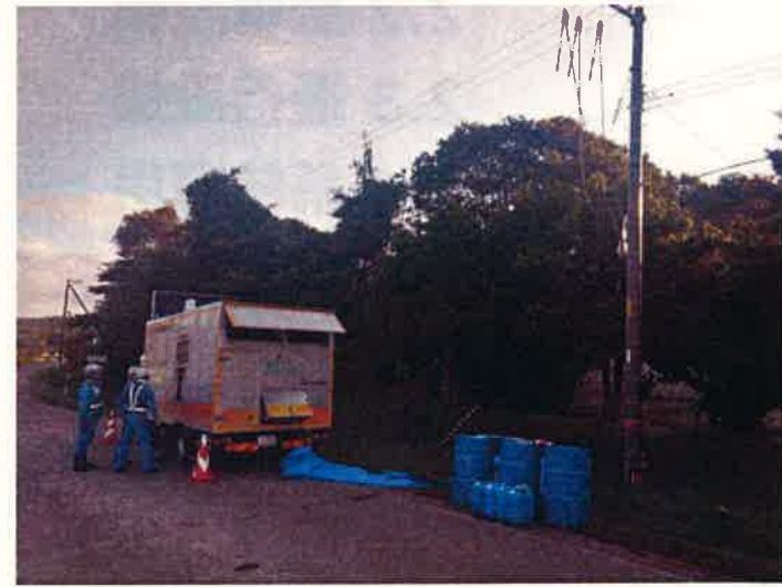
移動発電機車による応急送電
