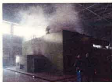
タービン出火状況
