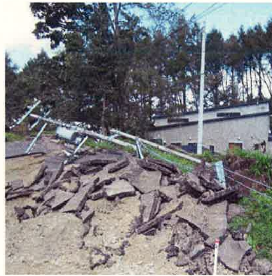
倒壊した柱上変圧器柱
