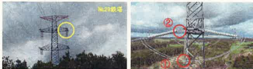
地震の揺れにより①ジャンパー線が②鉄塔に接触
