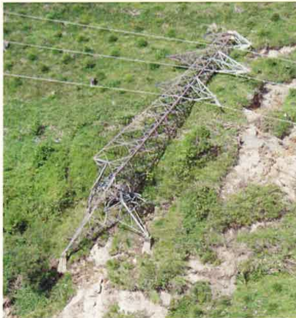
鉄塔倒壊箇所(岩知志線)
