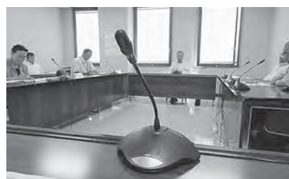
第1委員会室の音響設備も更新。
