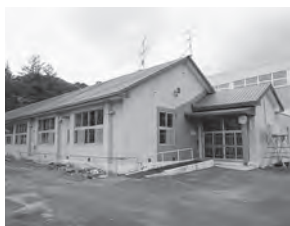
老朽化が進み、活用が難しい旧下人舞小学校。
