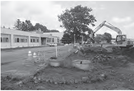
福祉館として活用するため、改修工事を行っている旧熊牛小学校。
