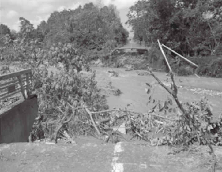
台風10号によるペケレベツ川の氾濫により、橋は残ったがその前の道路が大きく陥没した新錦橋。左奥にはマルマス十勝清水工場がある（9月2日、全員協議会における被害状況視察の際に撮影）
