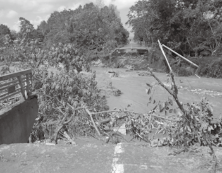
台風10号によるペケレベツ川の氾濫により、橋は残ったがその前の道路が大きく陥没した新錦橋。左奥にはマルマス十勝清水工場がある（9月2日、全員協議会における被害状況視察の際に撮影）
