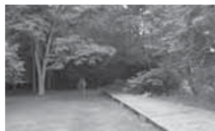
破損のため一部通行不可能になっているペケレの森の木道散策路
