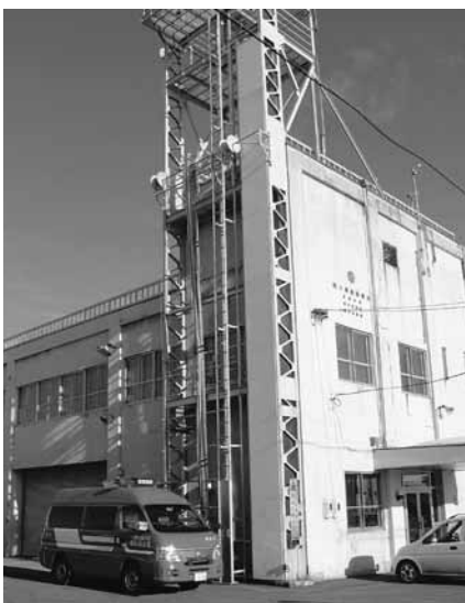
清水消防庁舎は築42年が経過しており、耐震上、整備が必要となっている。
