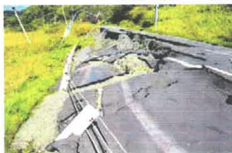
平成 15 年十勝沖地震 (豊頃町)
