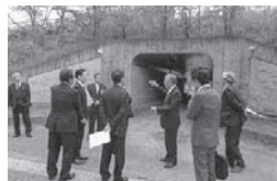
体育館との連絡通路（トンネル）は照明が損傷しており、壁などの汚れが目立つ
