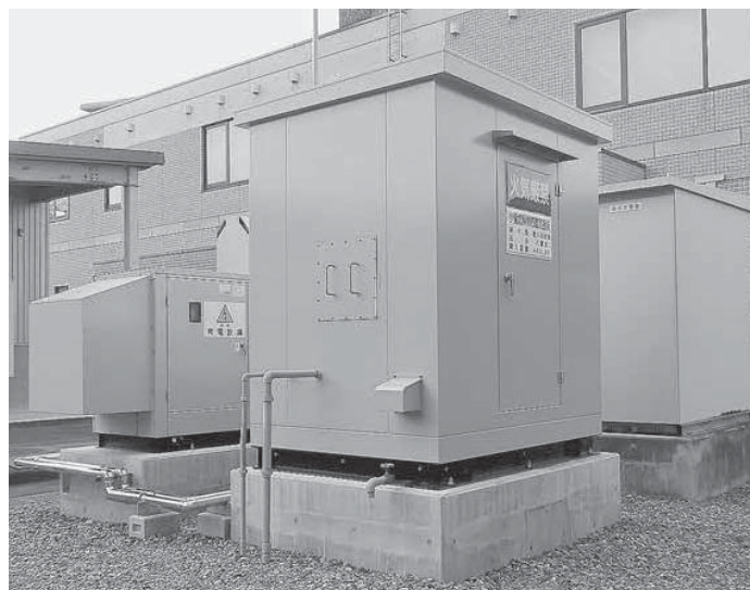
昨年度、役場庁舎に非常用発電機が設置され、停電時も防災行政無線の放送が可能に
