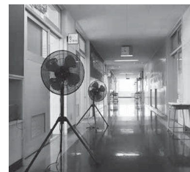
学校内に設置されている大型扇風機
