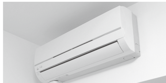
各教室につき1台、エアコンが設置される。
