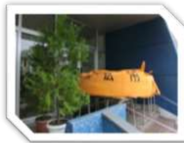
玄関先の給水タンク
