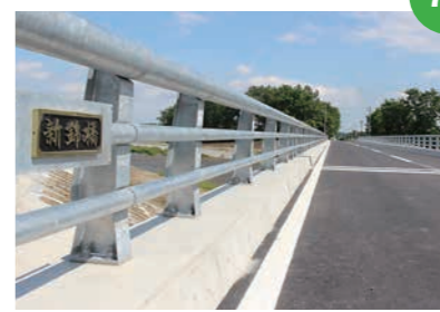
平成28年台風10号災害で被災し通行止めになっていた「新錦橋」が開通。
