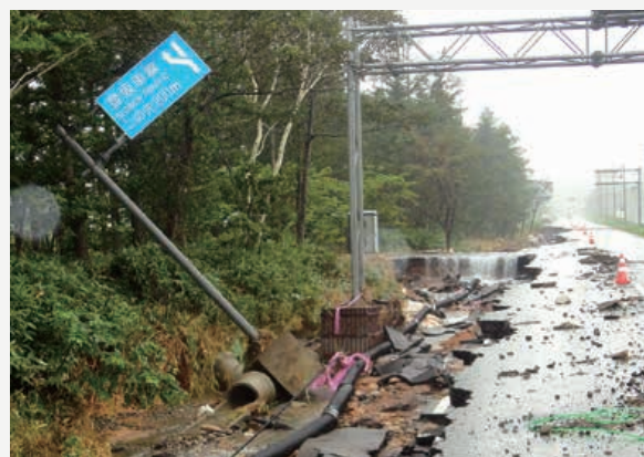
陥没なども起こり、多数の道路が通行止めとなりました。
