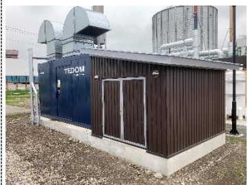
▲ガス混合ユニット
