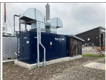
▲自家消費発電機
