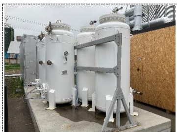
▲精製ガス運搬貯蔵タンク
